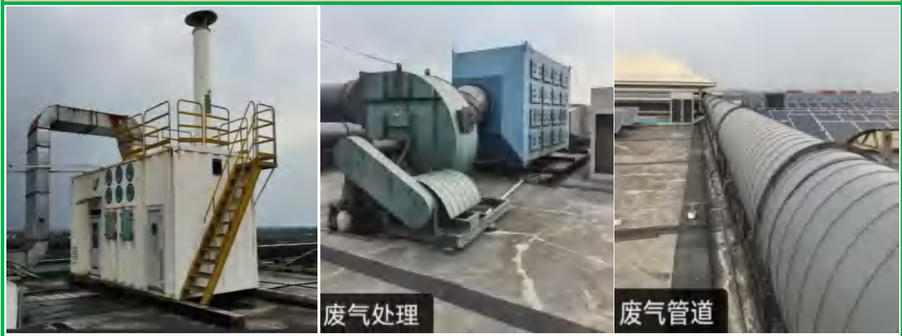
废气处理系统部分图片
